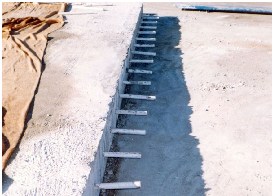
شکل ۷ - یکدست نبودن طول و راستای داوولها باعث انتقال نامتقارن نیرو و تمرکز تنش در لبه دال ها می گردد
