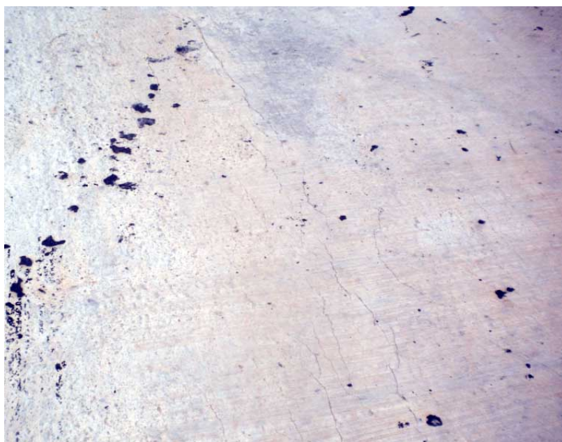
شکل ۱۱- در دال A26 ترکهای جمع شدگی زمان اجرا و توسعه آن در اثر انقباض و انقباض مشاهده می گردد.
